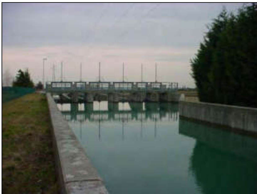
Figura 8 - Manufatti partitori alla presa del Giulio
