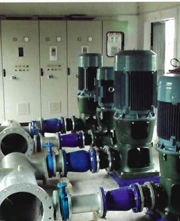
Stazione di pompaggio
